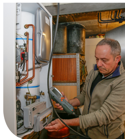
Installateur réalisant un réglage avant passage au gaz H
