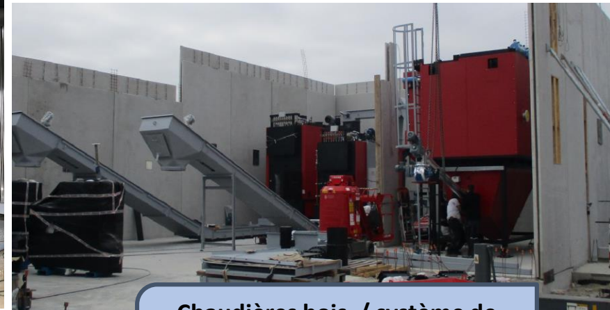
Chaudières bois / système de filtration et convoyeurs à cendres – Août 2019
