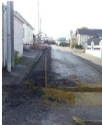
Les travaux ont démarré lundi et doivent se terminer autour des fêtes de fin d'année.
