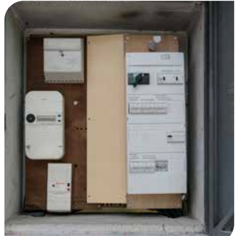
Armoire de commandes du SyDEV à Montauigu
