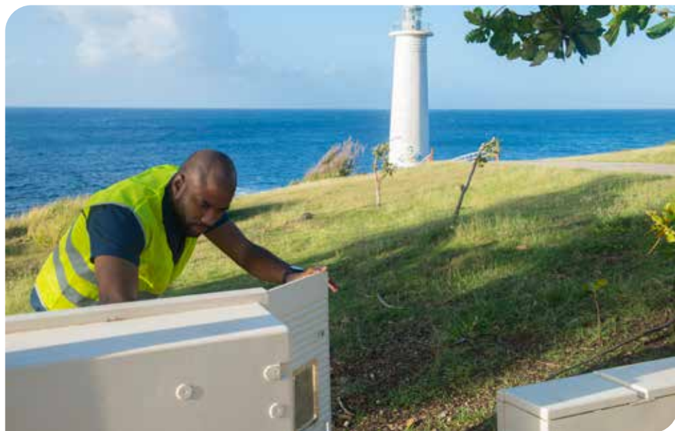
Entretien et maintenance du réseau d'éclairage public du SyMEG - Territoire d'énergie Guadeloupe
