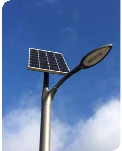
Commune de Yèbles, mât solaire installé par le SDESM 77
