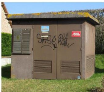
Le transformateur de la rue de Lamotte sera embelli.
